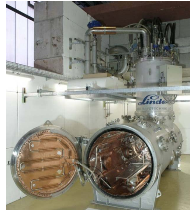
HoBiCaT at BESSY
