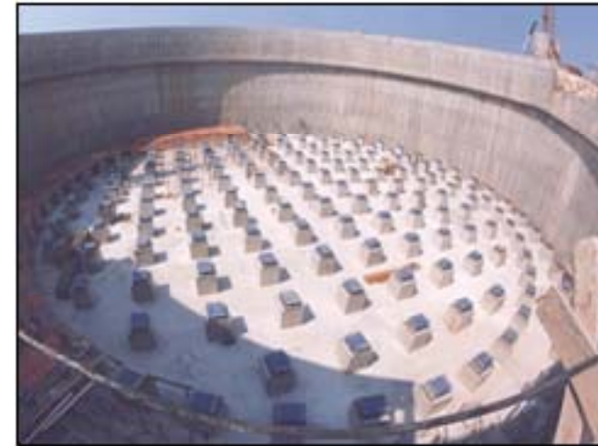
Greece LNG Tank
