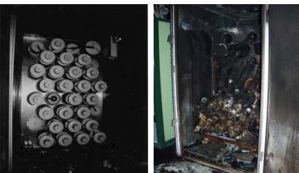
CTF3 Modulator (before-after fire)
